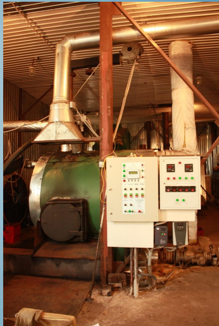
Котёл для сжигания гранулированного топлива с низкой температурой плавления золы. Мощность 300 кВт.
